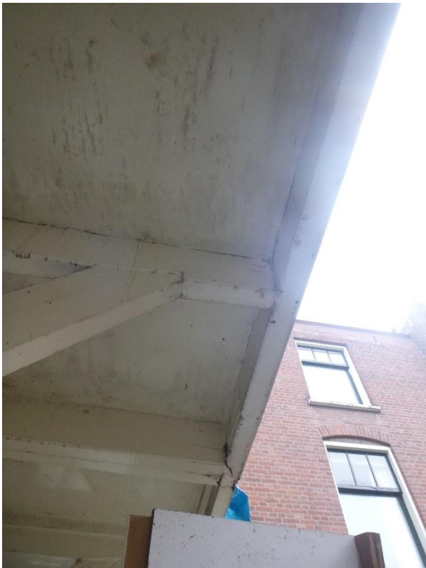
Foto 07: Onderzijde balkonconstructie achterzijde; De constructie vertoont aantastingen door vocht.
