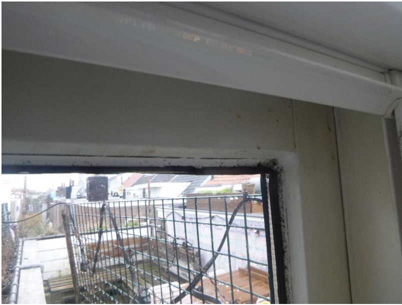
Foto 05: Appartement 4a: Het gevelkozijn in de achtergevel is voorzien van te kleine beglazing.
