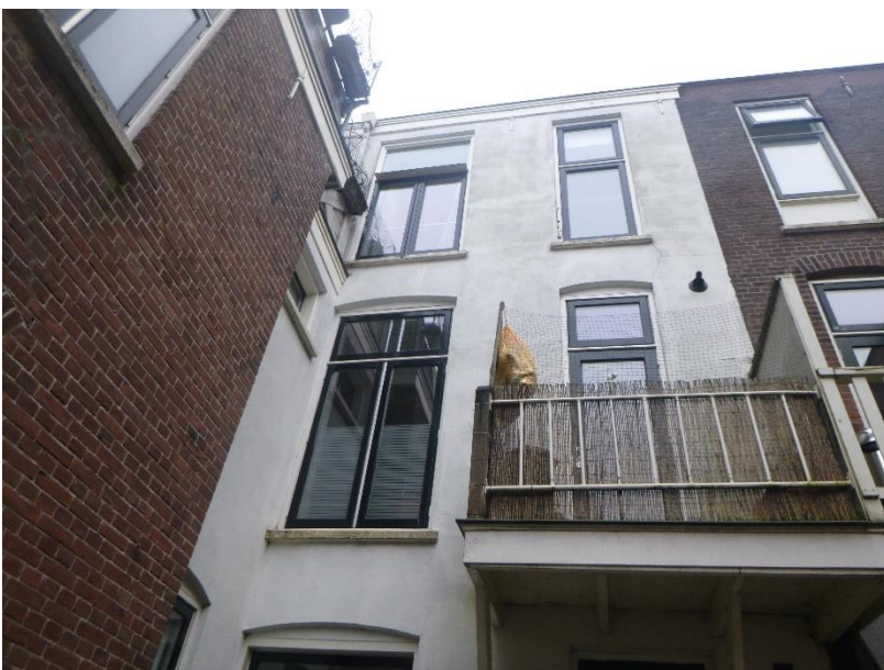
Foto 08: Achtergevel; Diverse gevelkozijnen vertonen grootschalige aantastingen door vocht.
